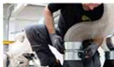
Maschinenanschluss an bestehende Abauganlagen
